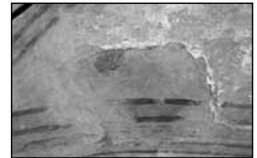
Pronao, particolare distacco intonaco vela sud-ovest
