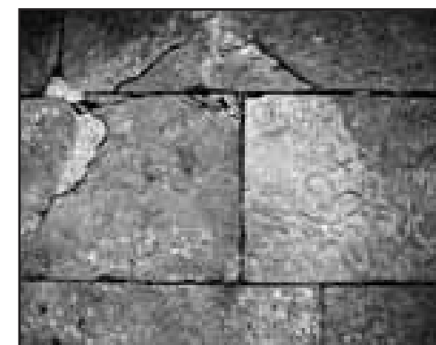
Edificio 2c), la pavimentazione originaria della corte in lastre di pietra di Sarnico
