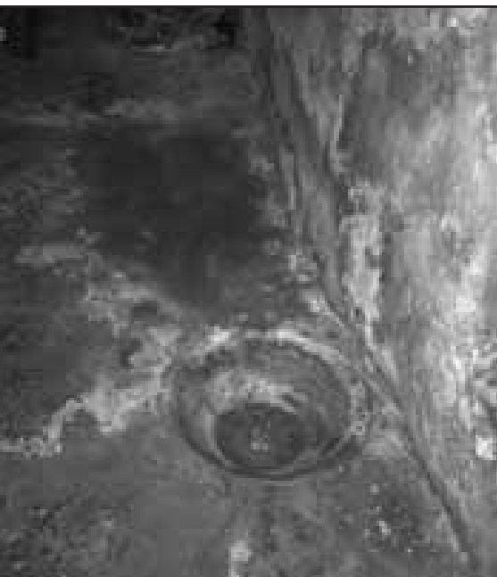
Edificio 2d), locale adibito a cantina, sul pavimento la bacinella raccogli-liquidi
